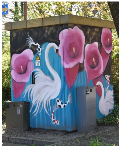
Kunst på et transformerhus nær jernbanen. Flere af byens transformatorstationer er i øvrigt udsmykkede.
